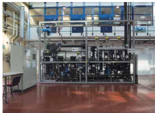
Fig. 5 - Unità Operativa Pilota (UOP) a CO 2 SFE
